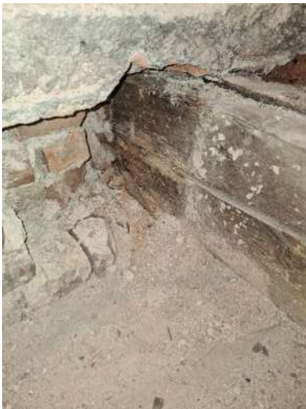
Foto. – HP, stropní trám do dvora, 3.NP
