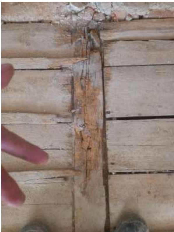
Foto. – napadený základ (M16), 3.NP
