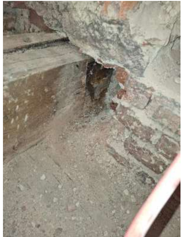
Foto. – HP, stropní trám do dvora, 3.NP
