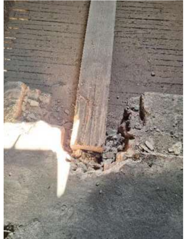
Foto. – HP-PP, stropní trám nad 5.NP
