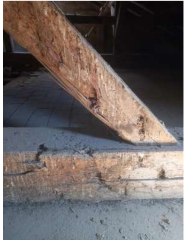
Foto. – plná vazba (M8, M9, M10) Atmosférická koroze
