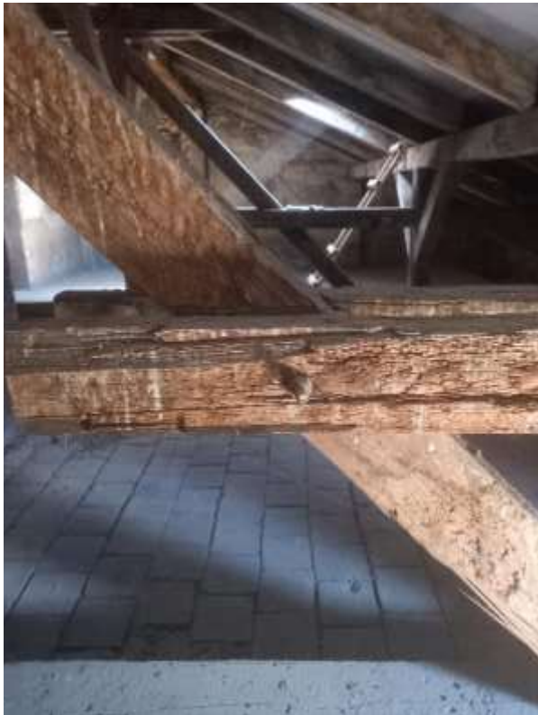
Foto. – plná vazba (M8, M9, M10) Atmosférická koroze
