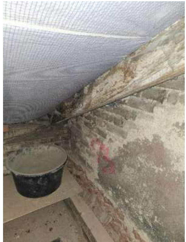
Foto. – HH, krokev, pozednice v místě zatékání
