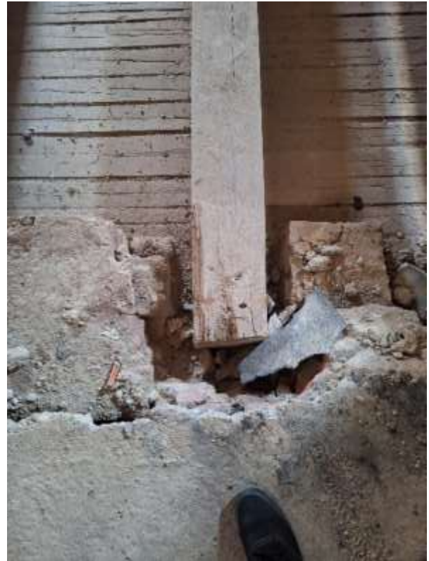
Foto. – HP-PP, stropní trám nad 5.NP
