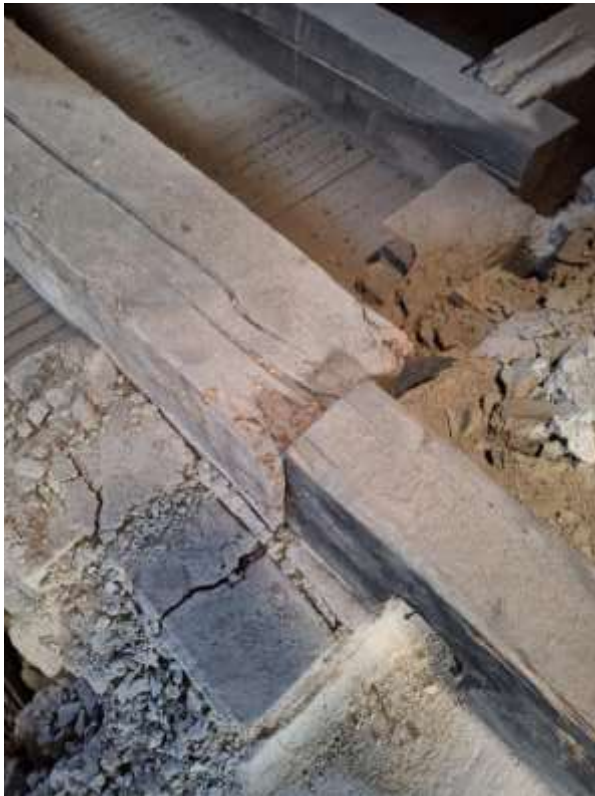
Foto. – HP-PP, Vazný trám
