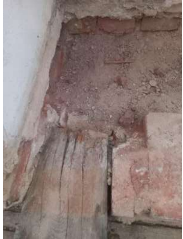
Foto. – HP-PP, stropní trám nad 4.NP
