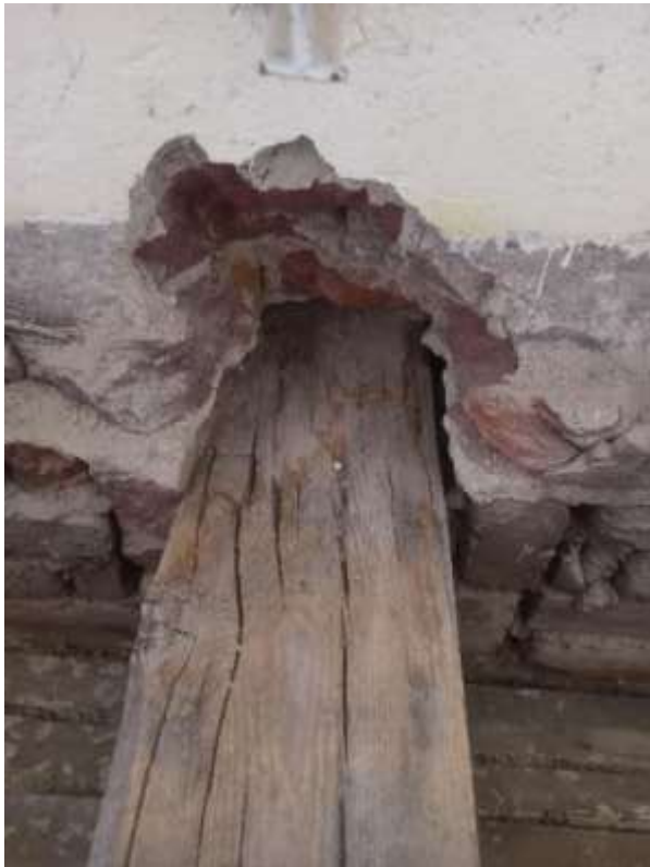
Foto. – HP-PP, stropní trám nad 4.NP
